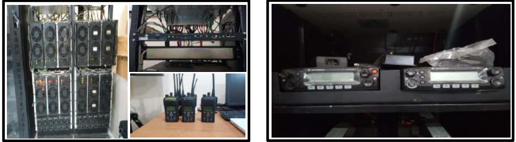
Dokumentasi Pemenuhan Alkom Siap Operasional
